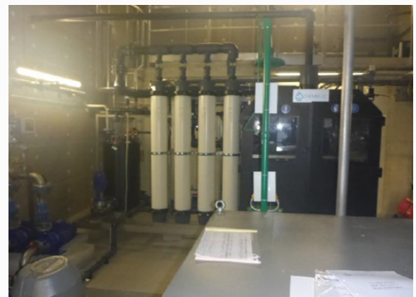
Usine de traitement de la turbidité et des pesticides des eaux de Bussy-en-Othe mise en service en 2020
