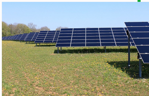
Parc photovoltaïque de Massangis
